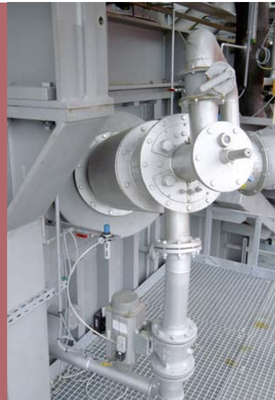
2.4 MW dust burner
