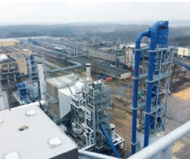
38-MW-Biomasse-Kraftwerk von Büttner
