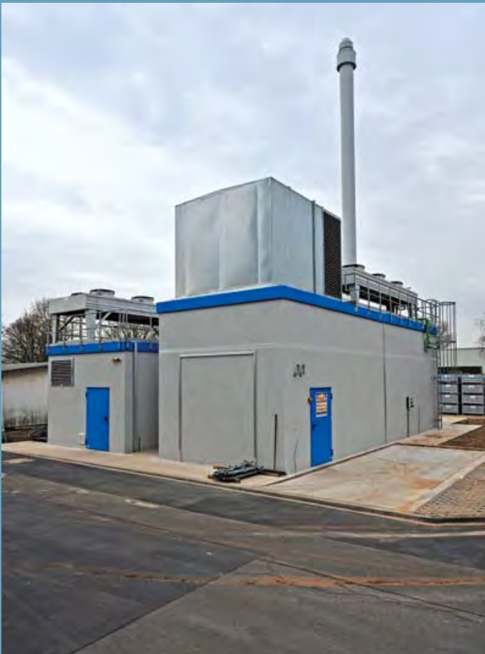
Das komplette Blockheizkraftwerk – viel Leistung auf wenig Raum
