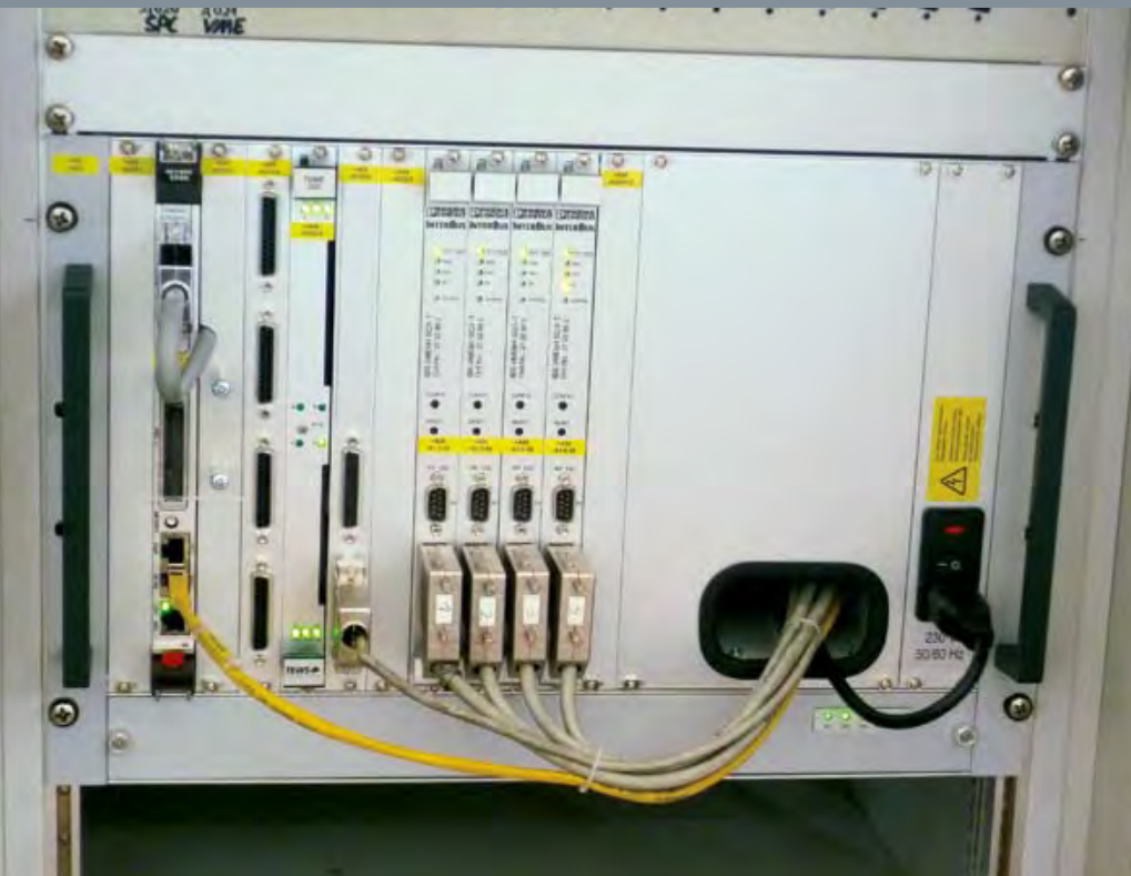
SPC-(Siempelkamp Press Control-)System
