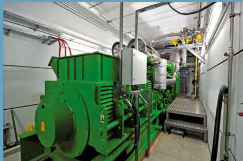
Der Motor im Blockheizkraftwerk
