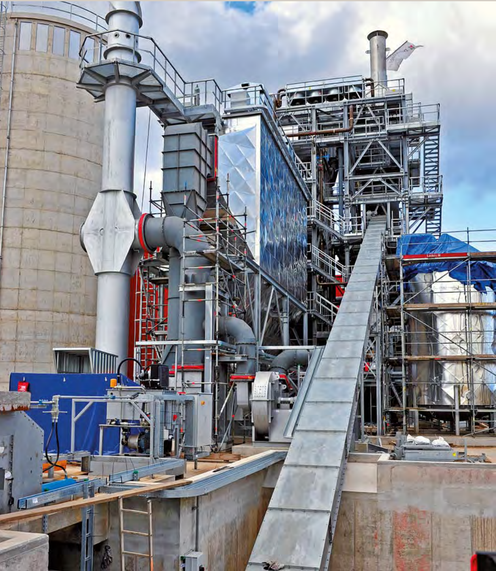
Das 13-MW-Heizkraftwerk von Büttner
