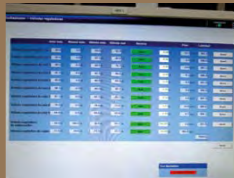
Durchflussanzeige im Kontrollerraum
